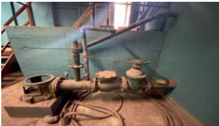
Figura 1: Estado de árbol de descarga previo a intervención
