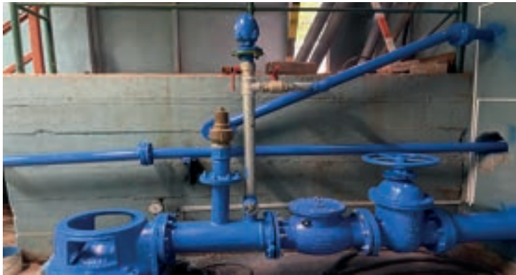
Figura 5: Árbol de descarga posterior a mantenimiento correctivo
